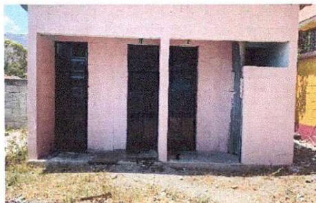
Foto 4: Puertas de baño
